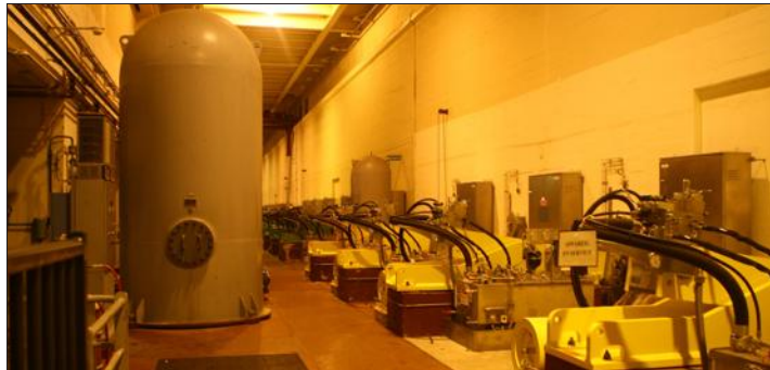
Dans la « salle des clapets », une vingtaine de vérins sont prêts à s'ouvrir au cas où le débit du Grand canal d'Alsace serait trop puissant pour les turbines de la centrale. Photo L'Alsace
