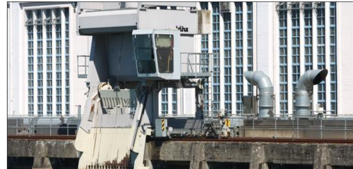
Un grillage est tendu dans l'eau pour retenir les déchets avant de parvenir à la turbine. Le robot « dégrilleur », installé sur rails, se charge de les repêcher. Photo L'Alsace
