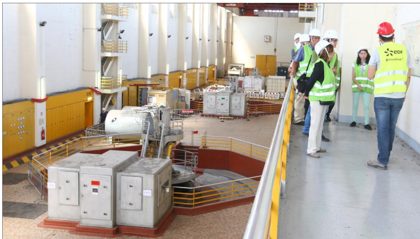
En contrebas du public venu visiter la centrale hydroélectrique, les alternateurs se dessinent dans le sol. Ils sont reliés à une turbine que l'eau fait tourner à 94 tours par minute, fournissant un courant de 10 300 volts ensuite converti en 225 000 volts pour être injecté sur le réseau EDF. Photos L'Alsace
